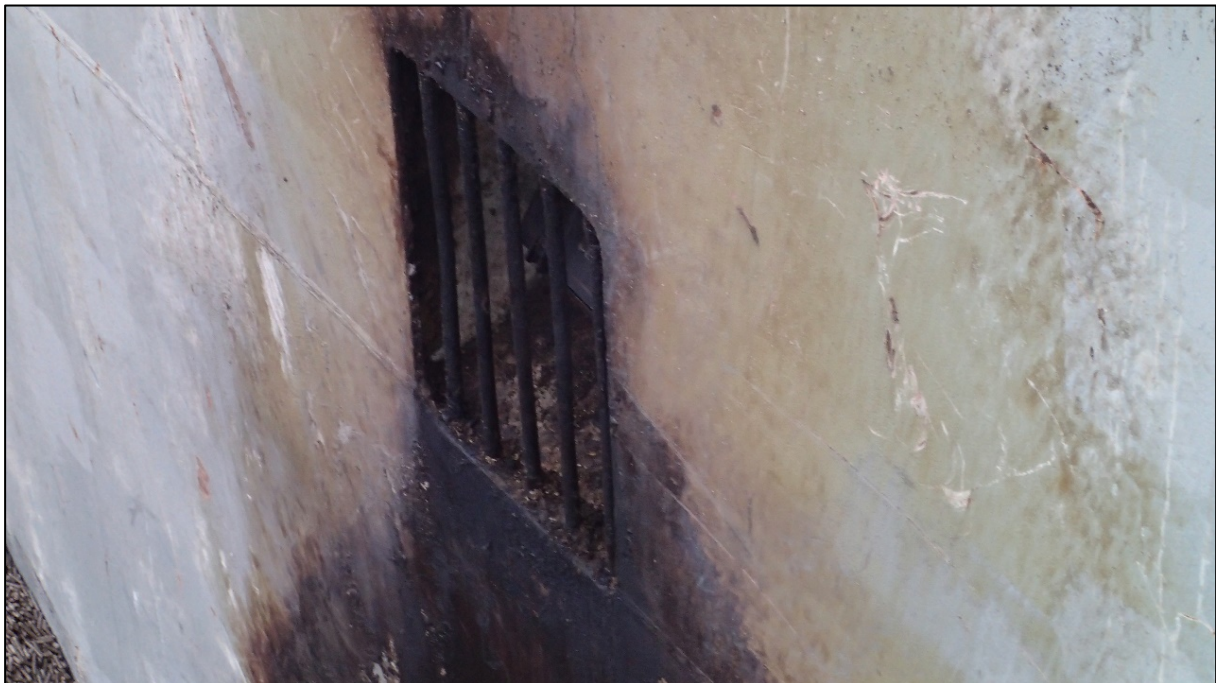
Abbildung 6: Brandschäden an der steuerbordseitigen Vorkante von Laderaum 1 Hier Brandschäden unterhalb und am Schutzgitter der steuerbordseitigen Lukenbeleuchtung.
