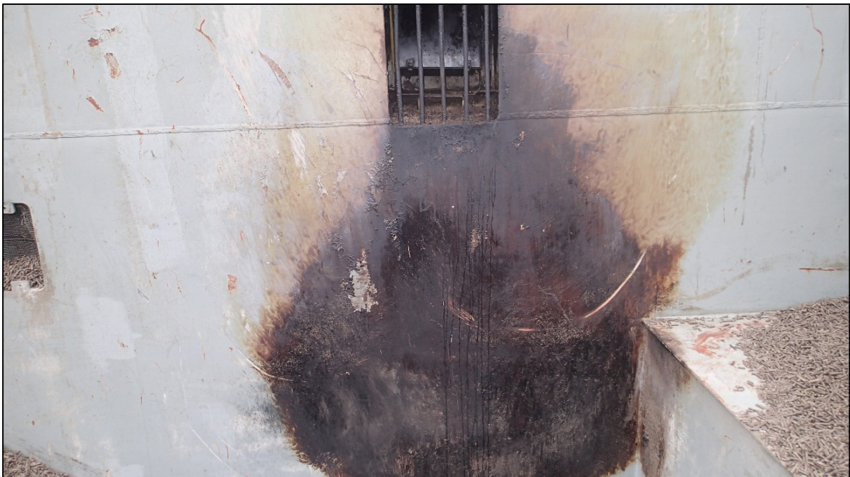
Abbildung 8: Schwelbrandbereich bis 2 m unterhalb des Laderaumstrahlers
