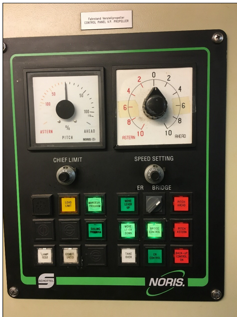
Abbildung 28: Fahrstand der Verstellpropelleranlage im Maschinenraum Zum Zeitpunkt der Aufnahme lag die Kontrolle auf der Brücke.
