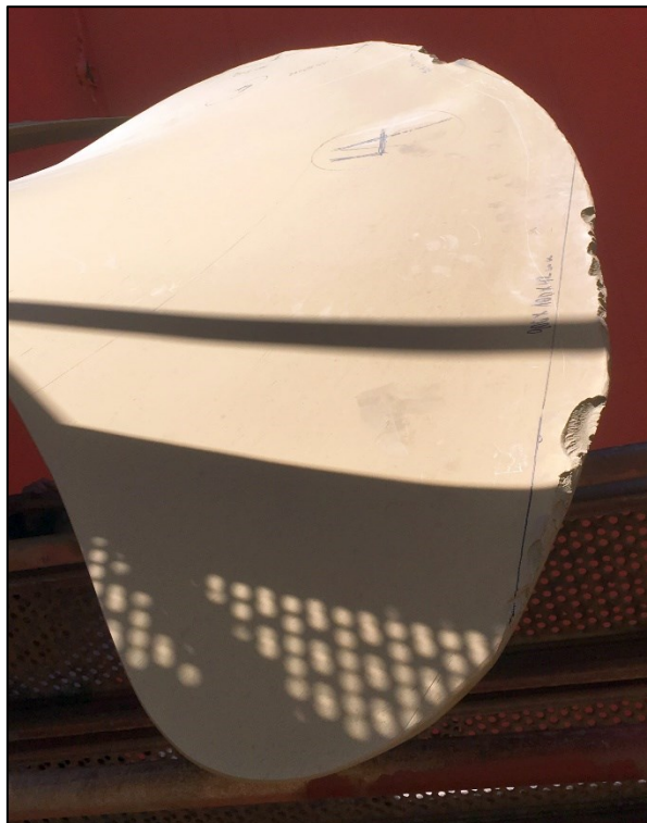
Abbildung 39: Weitere Beschädigungen an einem anderen Flügel
