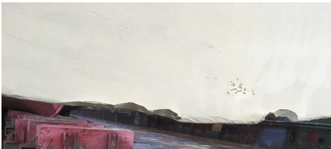
Abbildung 37: Nahansicht der Beschädigungen
