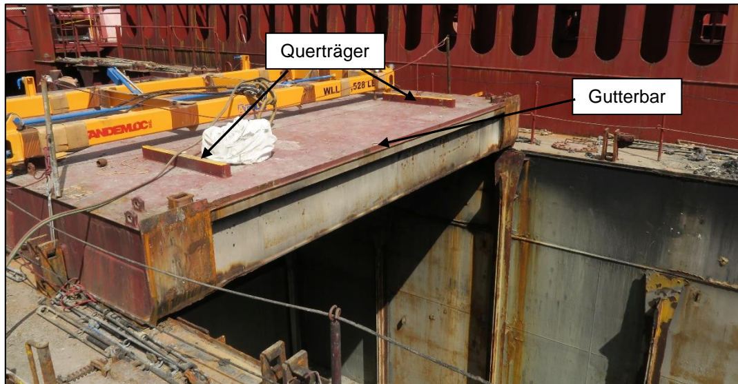
Abbildung 19: Laderaum 1 Bay 1, Gutterbar und Querträger
