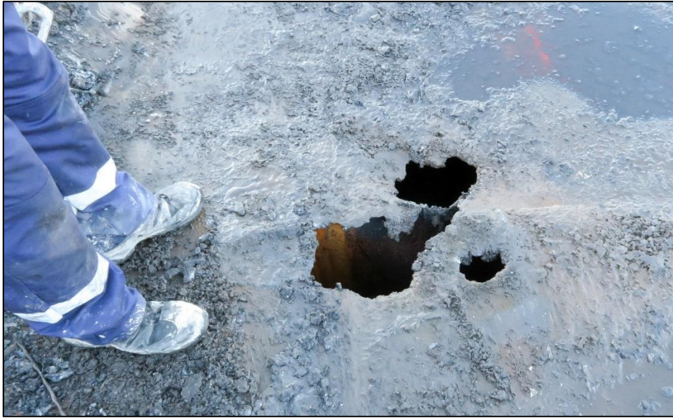
Abbildung 50: Vergleichbares Loch im Bereich des Stellplatzes 080182
