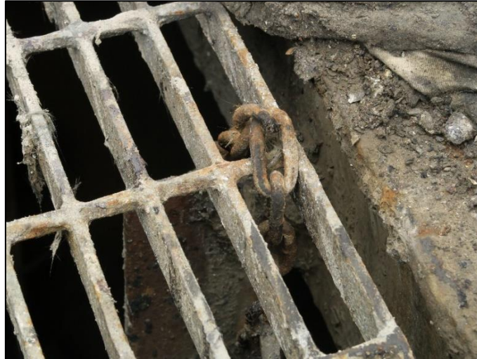
Abbildung 55: Gitter über Lüftungsöffnung mit Kette und Schloss gesichert
