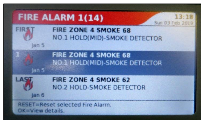
Abbildung 24: Anzeige der Brandmeldeanlage
