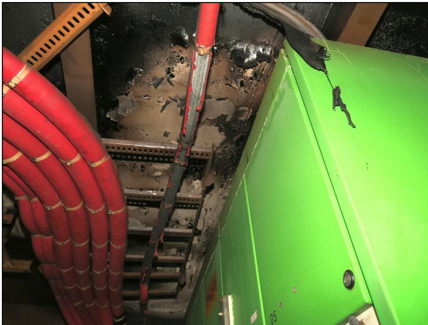
Abbildung 27: Thermische Schäden im Stb.-Passage Way auf Höhe Bay 7
