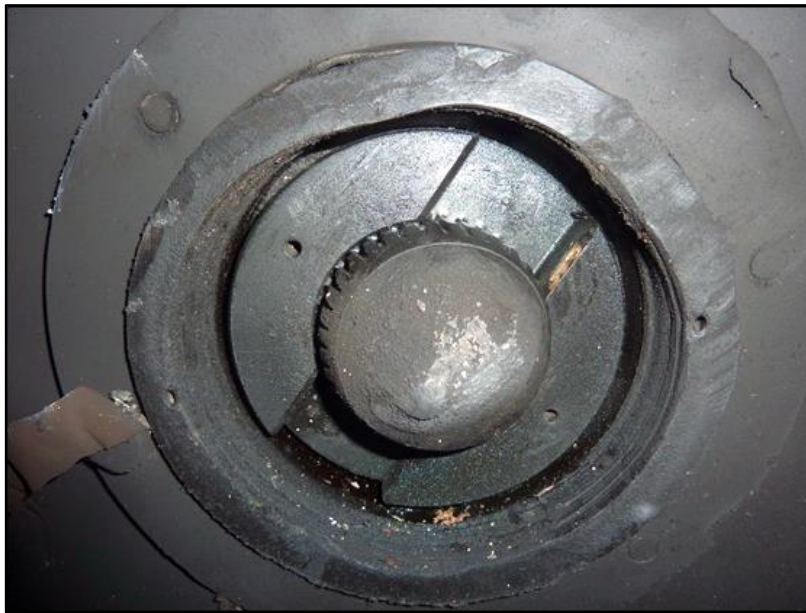
Abbildung 18: Bruchfläche auf der Welle mit Dauerschwingbruch
