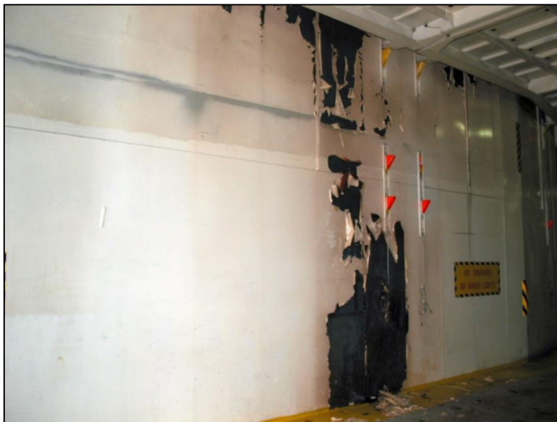
Abbildung 11: Schaden an der Farbbeschichtung
