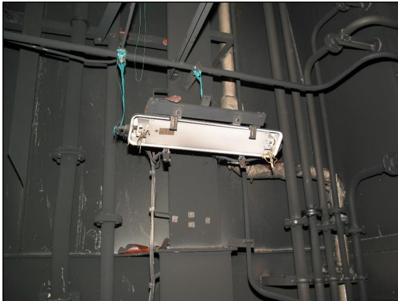
Abbildung 10: Schäden an Lampen und Kabeln
