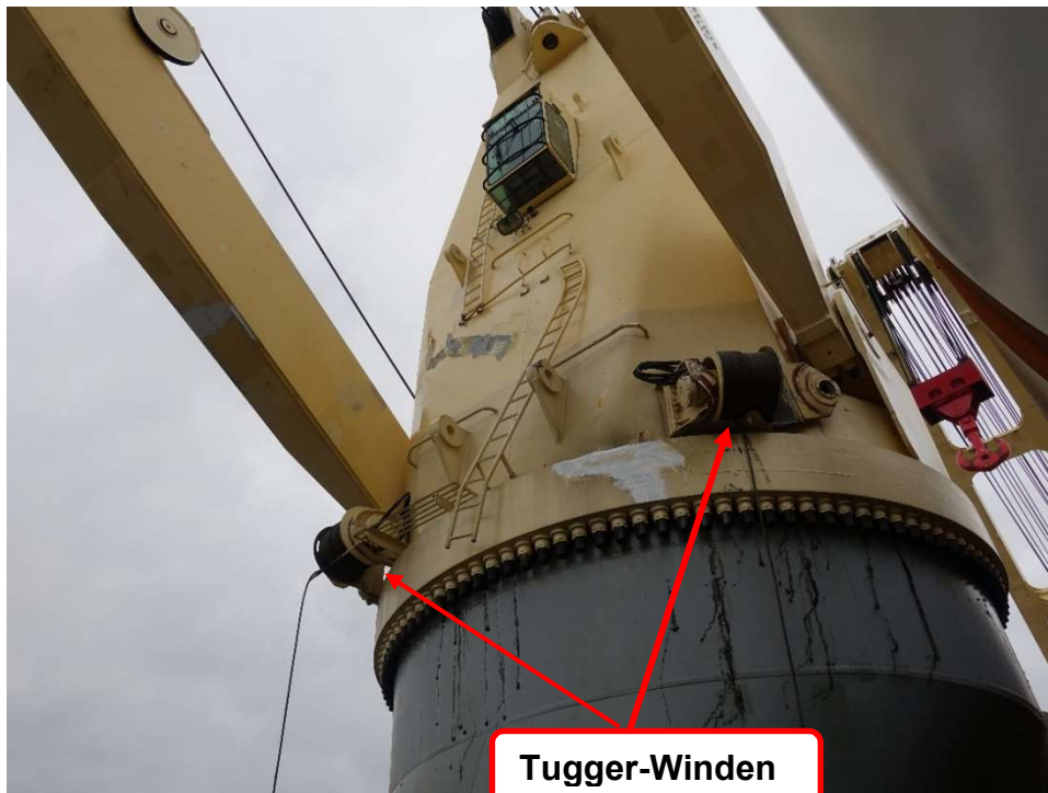
Abbildung 14: Beschädigung am Kran 2
