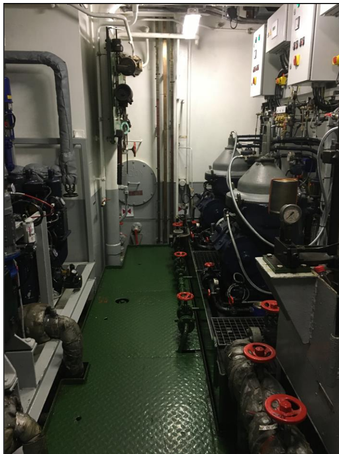
Abbildung 6: hinterer Bereich des Separatorenraums
