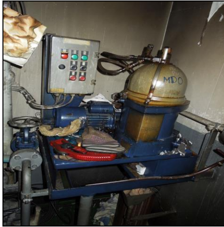
Abbildung 21: MDO Separator - weniger als 2 m vom Brandausbruchsort entfernt
