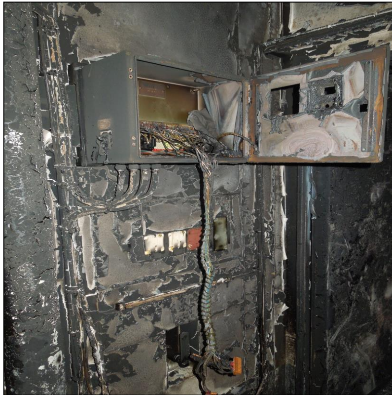
Abbildung 12: Schaltkasten der Regelventile mit heraushängendem Kabelstrang
