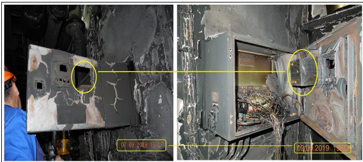
Abbildung 13: Veränderungen am Schaltschrank
