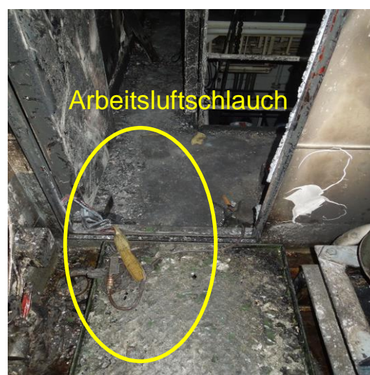
Abbildung 18: Blick aus dem Separatorenraum in den Maschinenraum Auf dem Boden liegend ist ein Arbeitsluftschlauch zu sehen. Er wurde zum Freiblasen des demontierten Rohrleitungsstückes verwendet.
