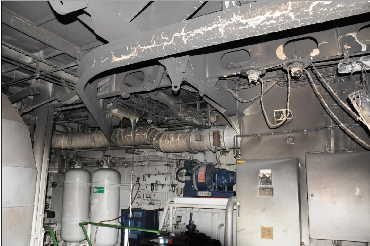
Abbildung 14: Brandzone unterhalb der Decke
