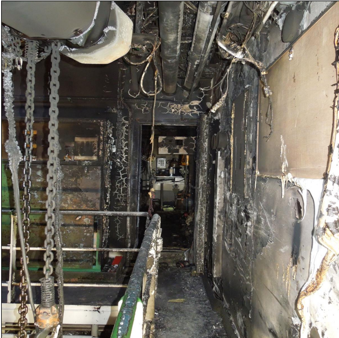
Abbildung 11: Blick vom gegenüberliegenden Maschinenkontrollraum in den Separatorenraum
