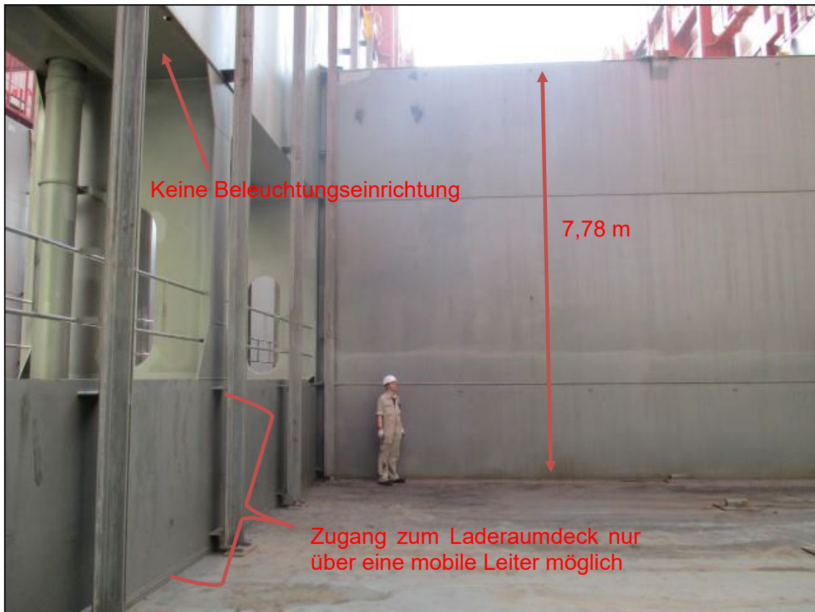
Abbildung 8: Fallhöhe, fehlende Beleuchtung, Zugang zum Laderaumdeck 20
