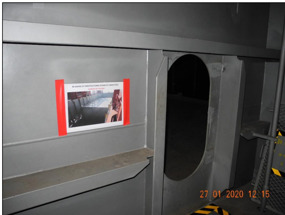
Abbildung 28: Foto mit der konkret vorzufindenden Absturzgefahr 80
