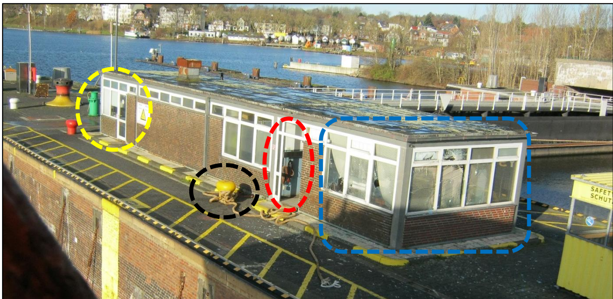
Abbildung 3: Betriebsgebäude auf der Schleusenmauer mit beschädigten Fenstern 5
