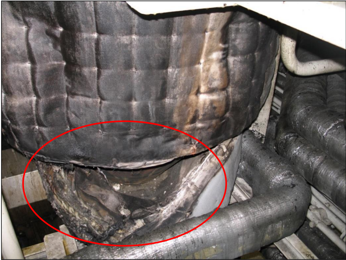
Abbildung 18: Brandspuren an den Isoliermatten der Abgasleitung
