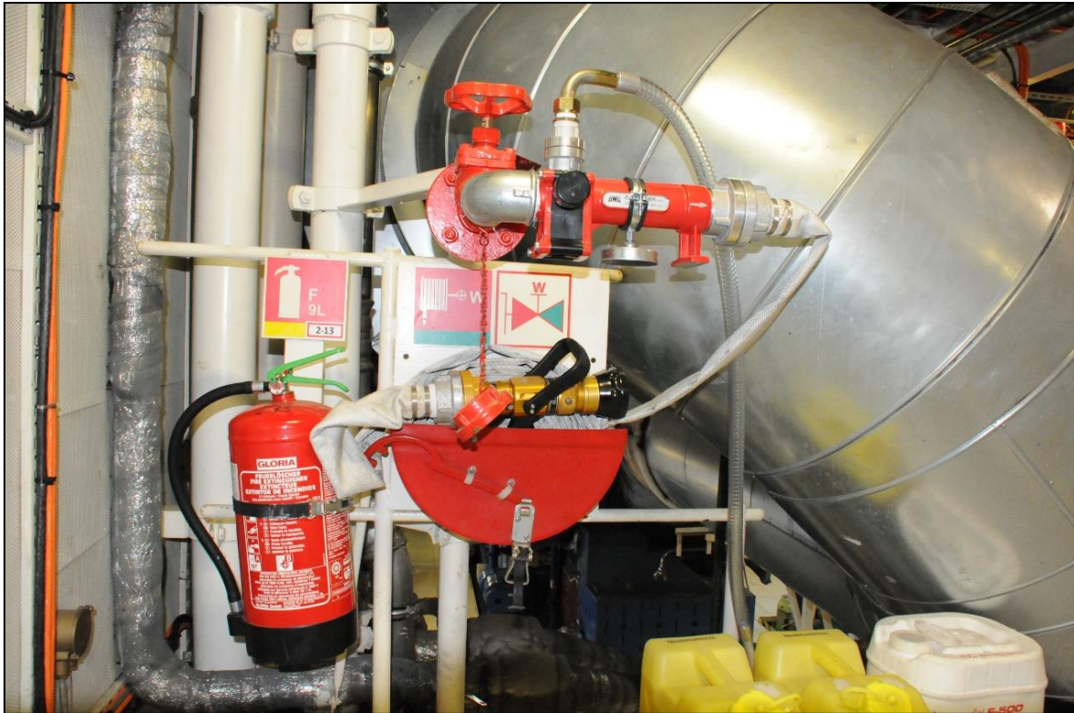
Abbildung 44: Hydranten-Station (Risiko-Bereich) mit festinstallierter Zumischung und Turbo-Strahlrohr
