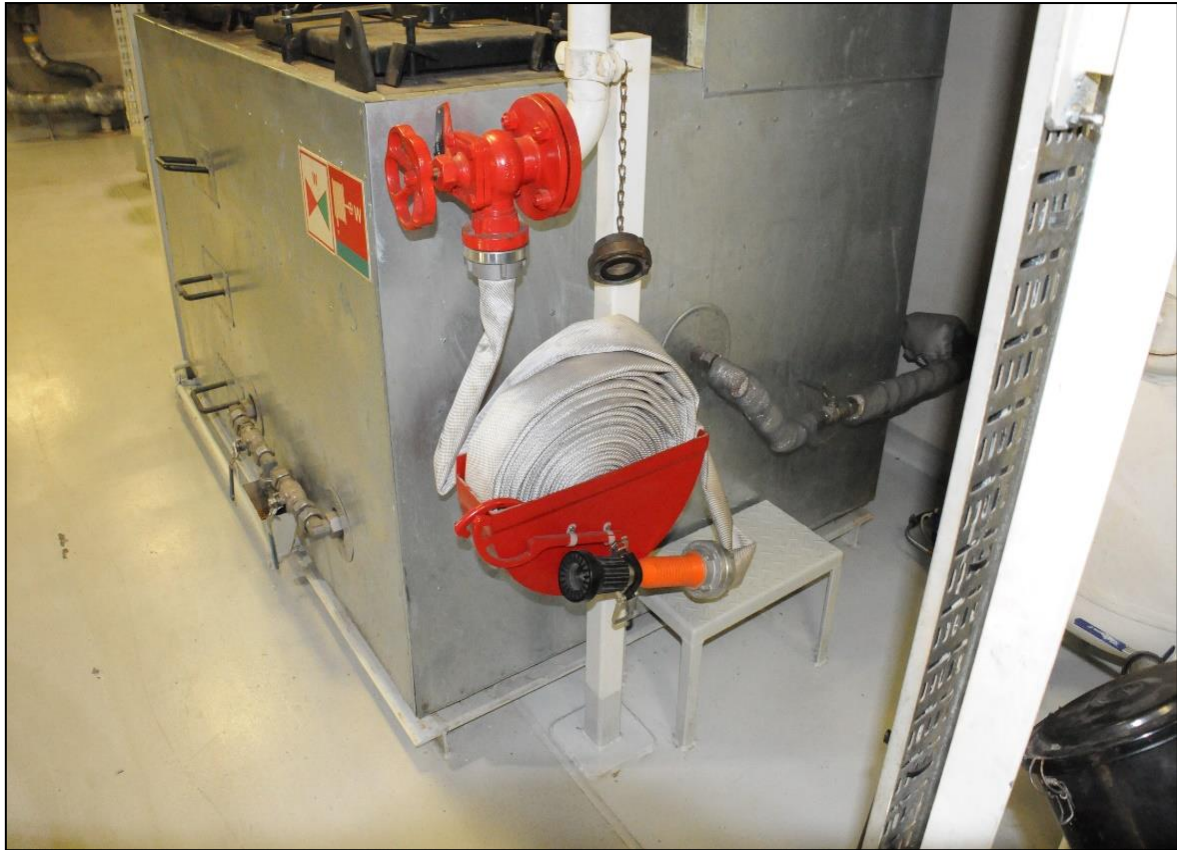
Abbildung 25: Standard - Strahlrohr / Hydranten System
