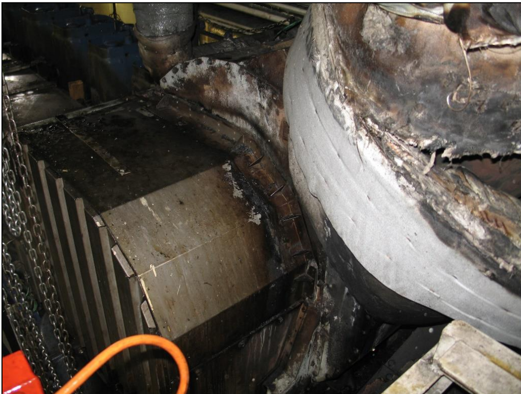
Abbildung 22: Brandschaden Abgasisolierung im Bereich des Turboladers
