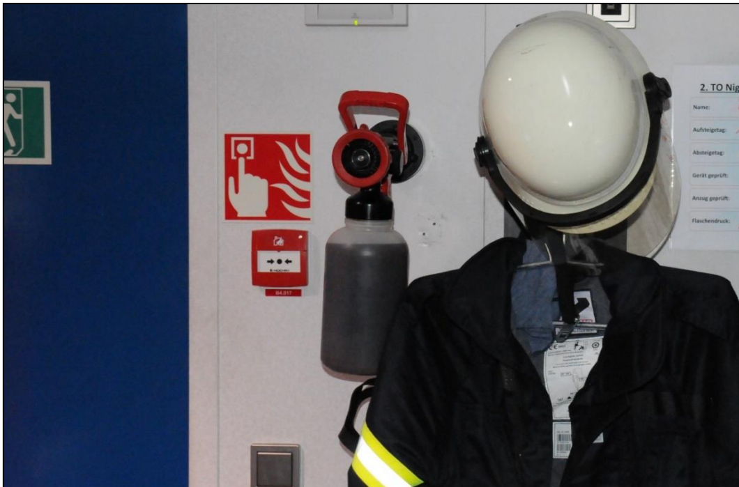
Abbildung 34: Venturi-Turbostrahlrohr mit 2 l F-500 EA zum flexiblen Erstangriff in allen Maschinenbereichen, positioniert im Engine Fire Locker (Brandabwehrausrüstungsraum)
