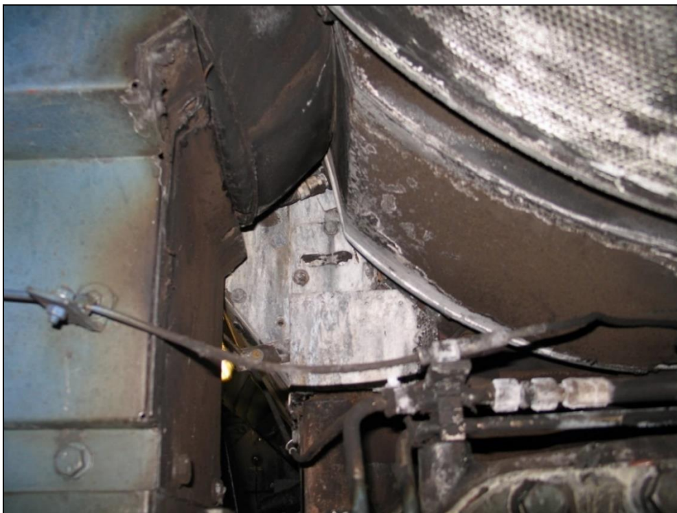
Abbildung 20: Brandschaden an der Abgasisolierung am Turbolader (Luftseite)
