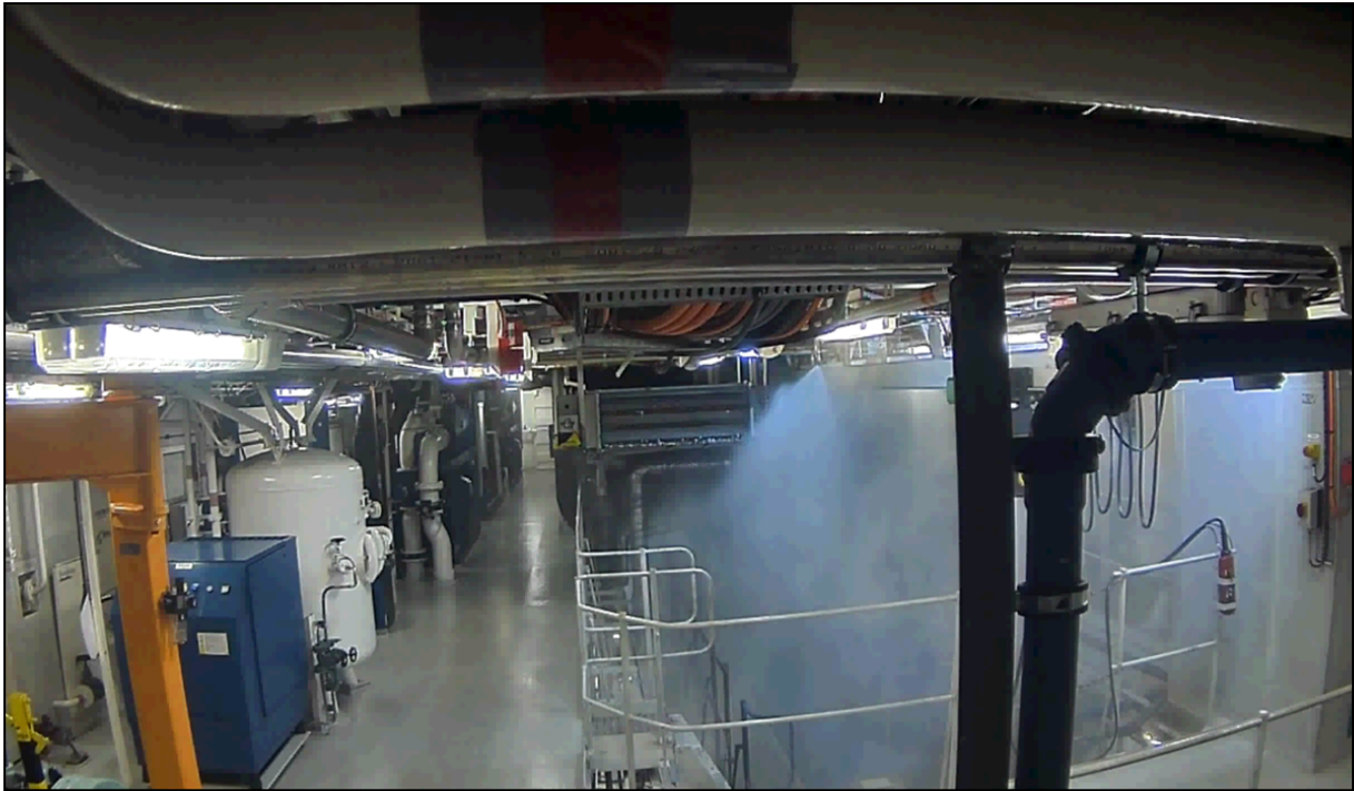
Abbildung 5: Ausgelöstes Objektschutzsystem über HM 3 10
