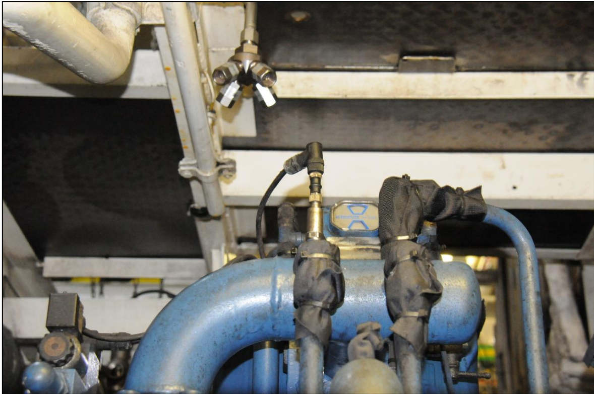
Abbildung 47: Drucksensor ersetzt Manometer am Getriebe
