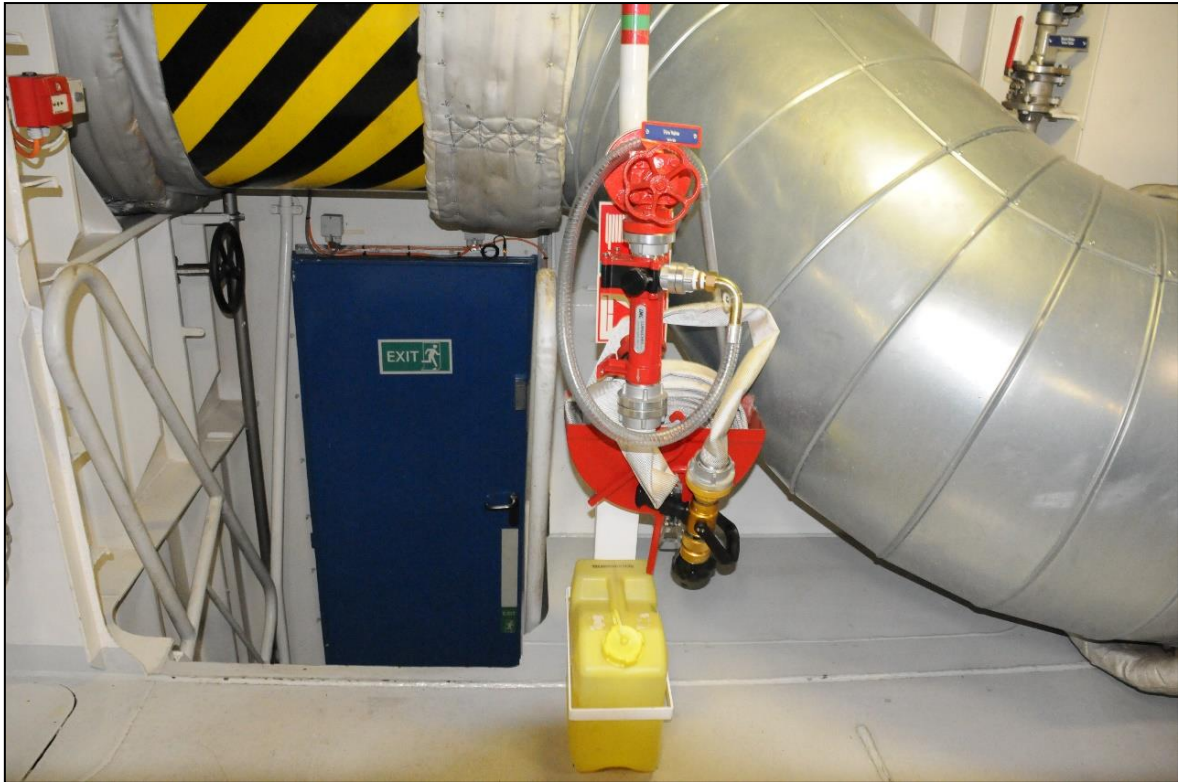
Abbildung 46: Hydranten-Station mit Schaum-/Netzmittelzumischung
