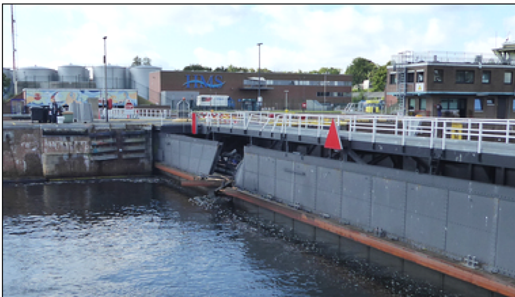
Abbildung 9: Beschädigung Schleusentor (Gesamtansicht) 24
