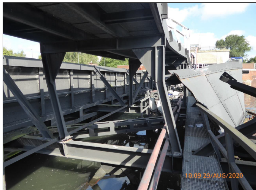
Abbildung 8: Beschädigung Schleusentor (Detailaufnahme 2)
