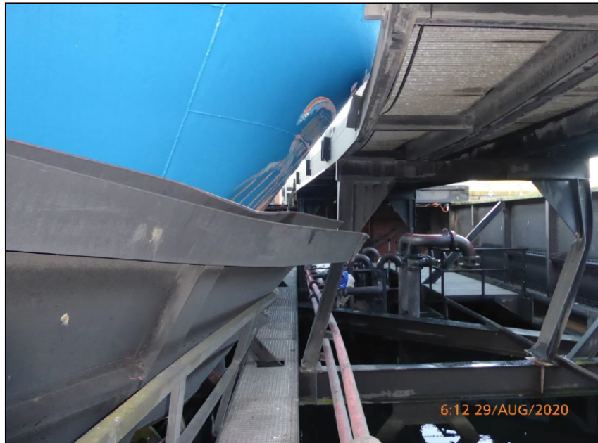
Abbildung 7: Beschädigung Schleusentor (Detailaufnahme 1) 23
