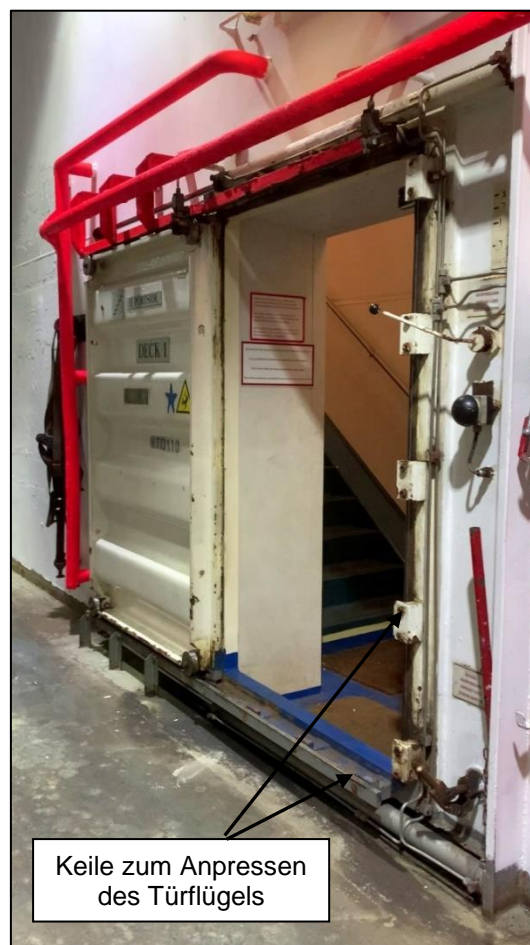
Abbildung 5: Wasserdichte Tür 110 in Deck 1 im geöffneten Zustand 8 Die roten Rohre dienen dem Schutz der Türmechanik. Rot ist auch die Führung der Tür an der Oberseite. Durch die Türöffnung hindurch ist das Treppenhaus erkennbar.
