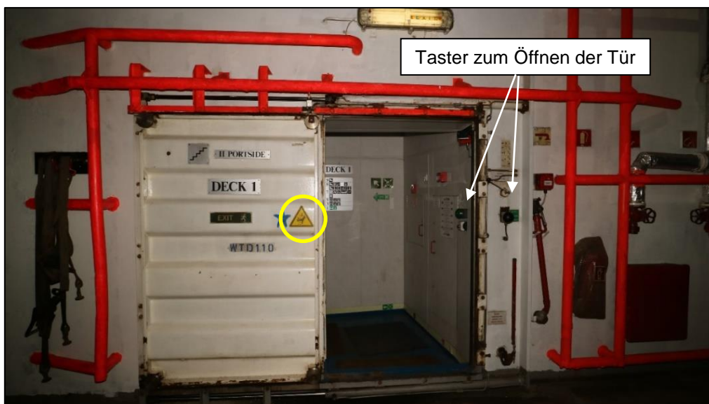
Abbildung 4: Wasserdichte Tür Nr. 110 in Deck 1 im geöffneten Zustand 7 Im gelben Kreis das Warnzeichen Quetschgefahr.
