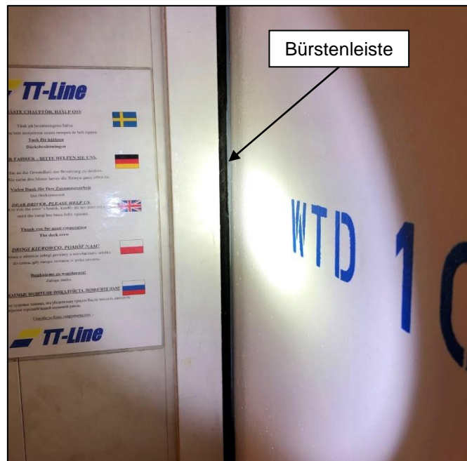
Abbildung 16: Wasserdichte Tür 108: glatte Oberfläche auf der Innenseite und Bürstenleiste auf der Seite, zu der die Tür öffnet 21
