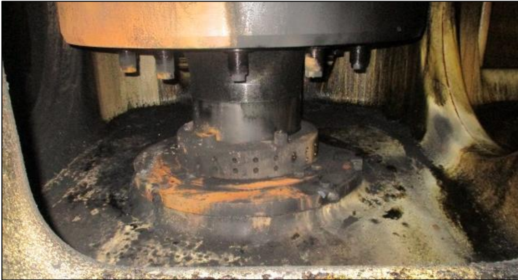
Abbildung 4: Zwischenboden mit Stopfbuchse eines betroffenen Zylinders 16 mit Löschwasser-Rostspuren
