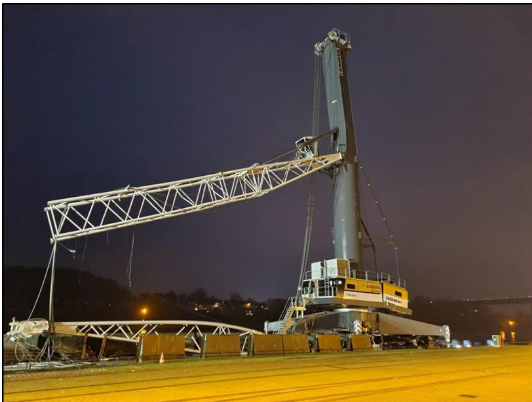
Abbildung 2: Übersichtsaufnahme des Krans mit durchgebrochenem Ausleger 4
